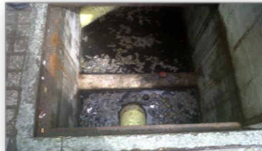
Foto No. 2. Caja de inspección externa
